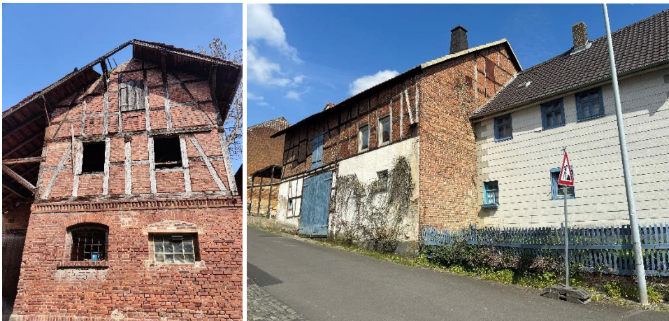
Abbildung 14: Beispiele für Häuser und Nebengebäude in Obervorschütz mit Leerstand und hohem Sanierungsbedarf
